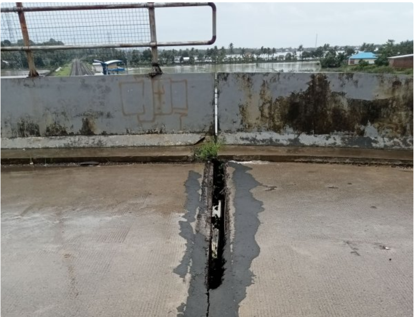
Sambungan jalan fly over Pekkae rusak parah
